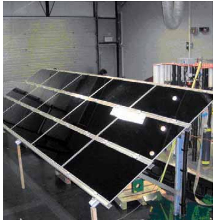
Fig. 6 : Laboratoire DEHN : Montage expérimental pour tester des surtensions induites dans un champ de modules provoquées par le champ magnétique généré par un courant de foudre à proximité
