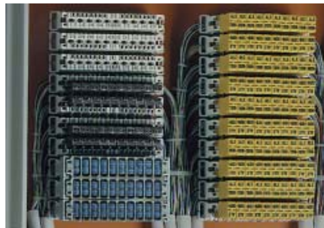
DPL 1 F Protection antisurtension du central de télécommunication ; DPL 1 F connecté sur la barrette de sectionnement LSAPlus
