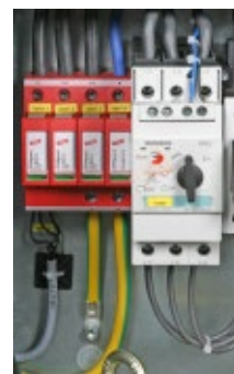
Figure 12 : connexion terre supplémentaire du parafoudre à travers le châssis métallique du tableau électrique
