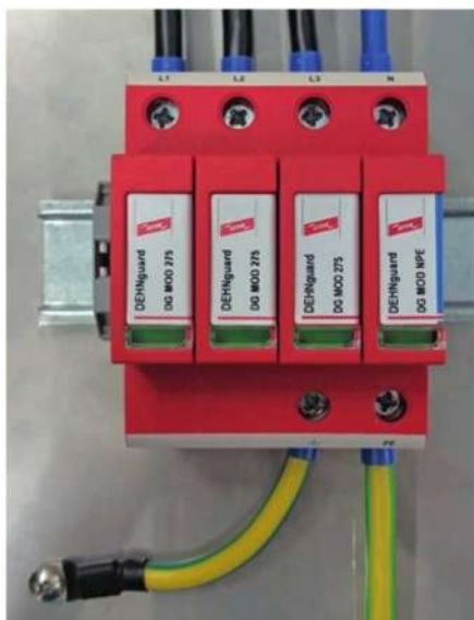
Figuur 6: SPD met directe verbinding van de aardklem met de montageplaat
