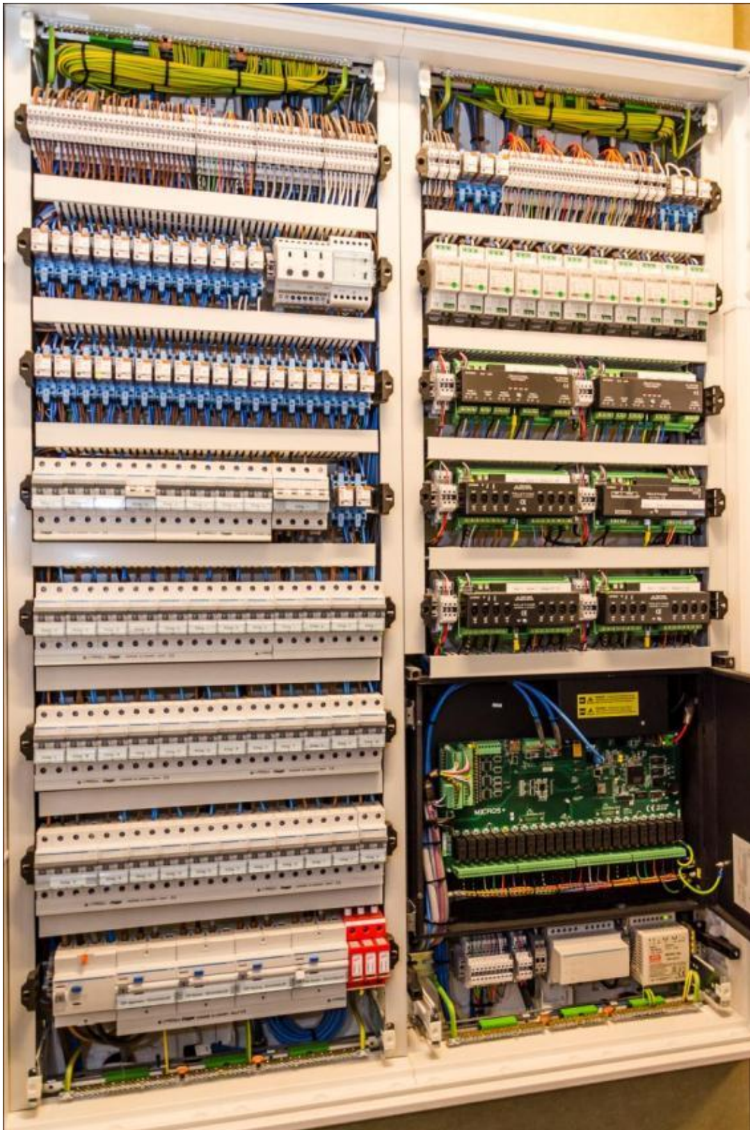
Figuur 74 : Voorbeeld schakelkast
