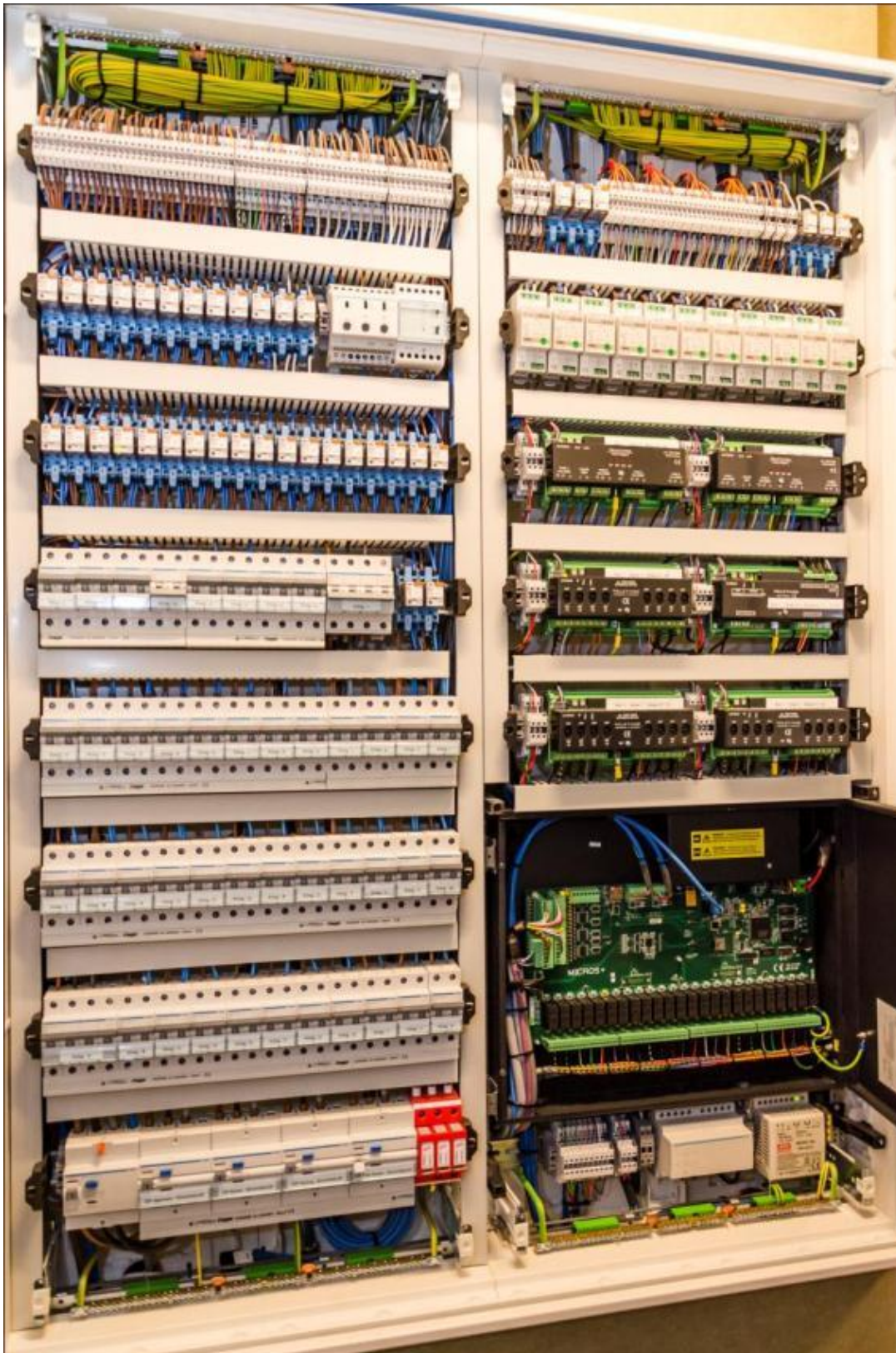
Figuur 74 : Voorbeeld schakelkast
